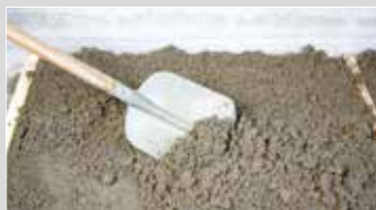
a- Pas d'armature dans le ravaillage.
