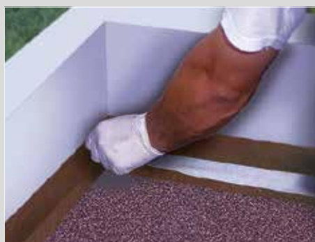
2- Collage de l'armature de renfort Alsan® Voile Flashing (développé 10 cm) à l'aide d' Alsan® Flashing (500 g/m 2 ).
