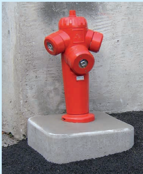
Poteau SAPHIR posé dans une rue en pente, avec un socle Carnot.
