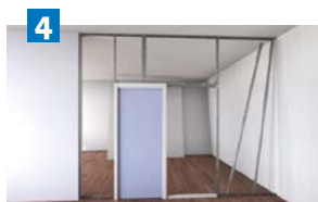
4 Finition de l'ossature de la cloison et vissage des plaques de plâtre BA 13.
